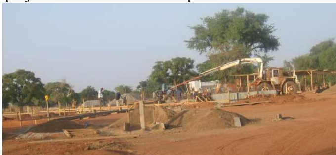
Photo 7: Site de pompage d'eau pour la ville de Kaya,
